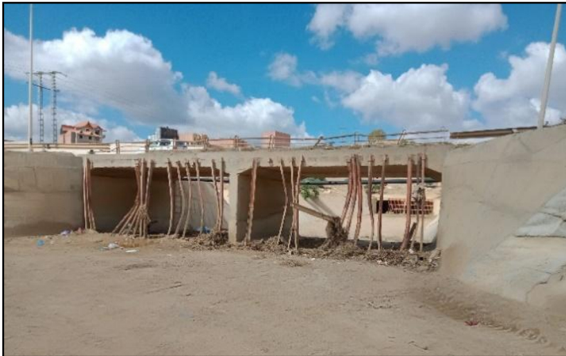
Photo 6. Trash trap before reaching the entrance to the water tunnel (phot. by F. Tout, 2020) Fot. 6. Pułapka na śmieci przed wejściem do tunelu wodnego (fot. F. Tout, 2020) Фот. 6. Мусорная ловушка перед входом в водный туннель (фот. F. Tout, 2020)
